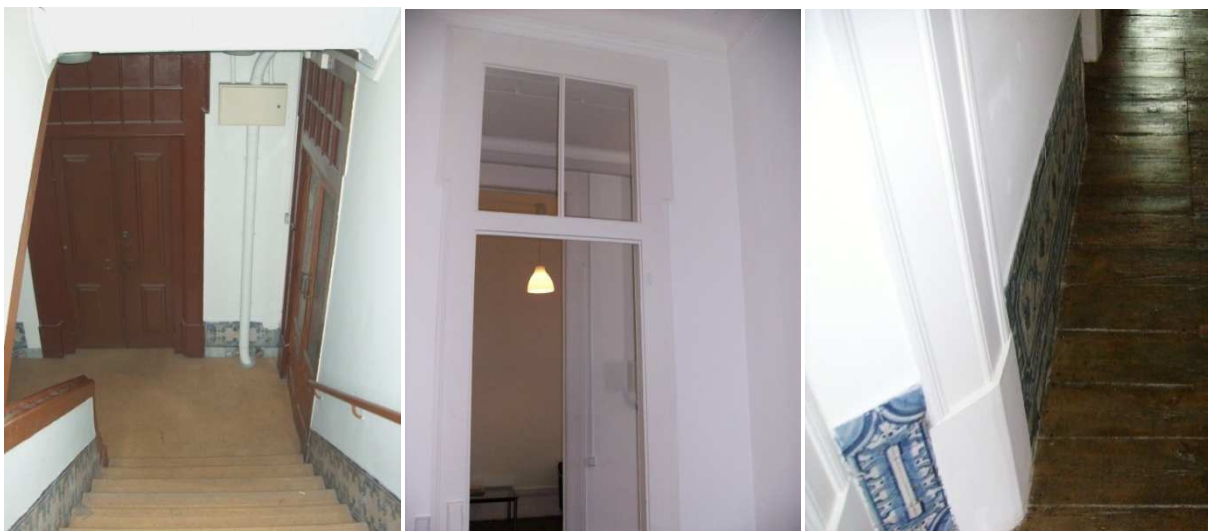
Figura 56 – Perspectivas de um edifício pombalino em que foram mantidas as características originais
